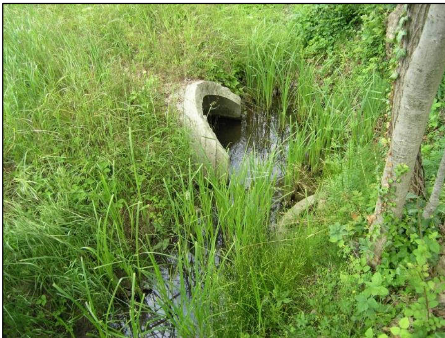
FOTO N. 2 – Uscita tratto tombinato Ø100, a nord della “S.R. N. 245”
